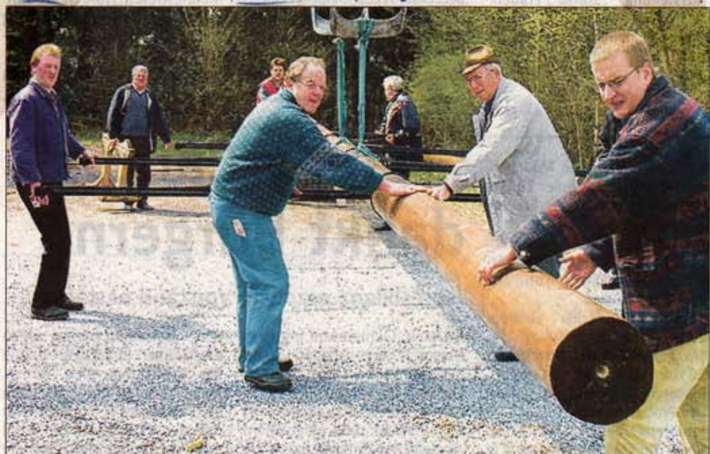
Die Vorbereitungen für das Aufstellen des Maibaums, der jetzt den Vogelstangenplatz auf der Anhöhe schmückt, mit einem Kran laufen auf Hochtouren. Fotos (2): Paul Josef Bühner
