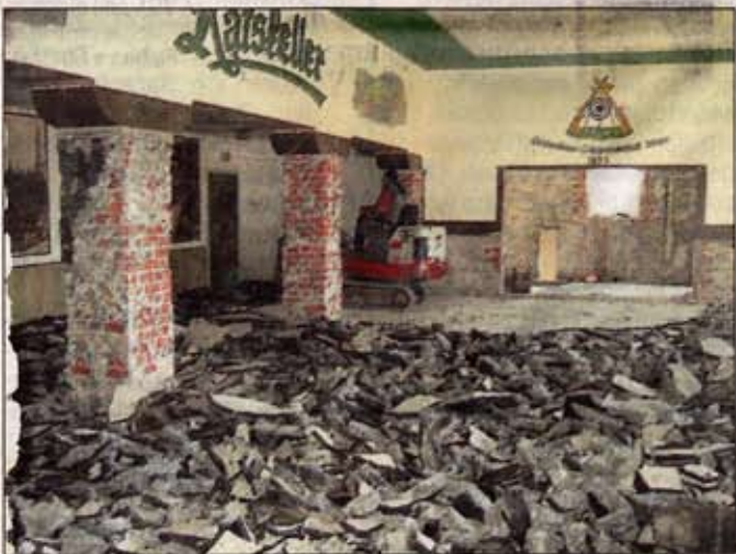
Mit einem Minibagger wurde der komplette Fußboden im Ratskeller der Möhnetalhalle herausgerissen. ■ Foto: Franke
