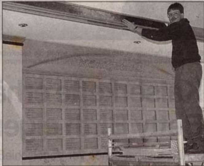
Andreas Filthaut beim Anbringen der Spiegelstreifen für die neue Deckenverkleidung im Eingangsbereich der Halle.
