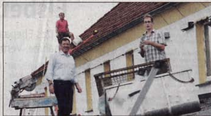
Die Arbeiten zur Errichtung der Photovoltaik-Anlage auf der Möhnetalhalle haben begonnen. • Foto: Franke
