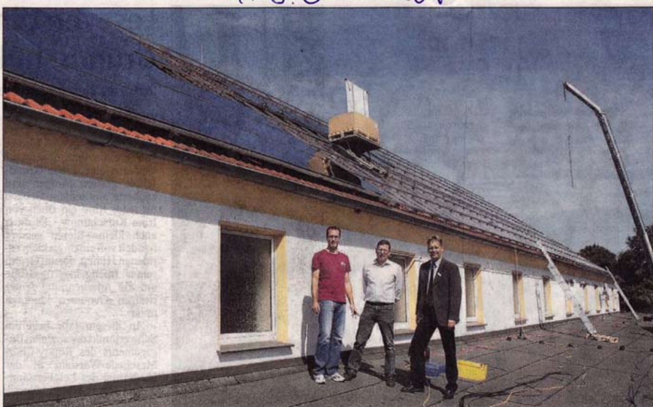
Sie sind stolz auf die neue Photovoltaikanlage auf dem Dach der Schützenhalle: v.l. Oberst Walter Risse, Rendant Hans-Jürgen Severin und Thomas Goesmann von der Sparkasse Lippstadt.
