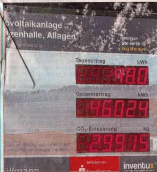
Auf einer Anzeigetafel sowie im Internet lassen sich die Erträge der Allagener Anlage verfolgen.
